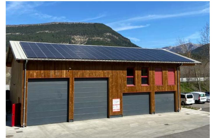
▲ Installation d'une nouvelle centrale de 30 kWc
